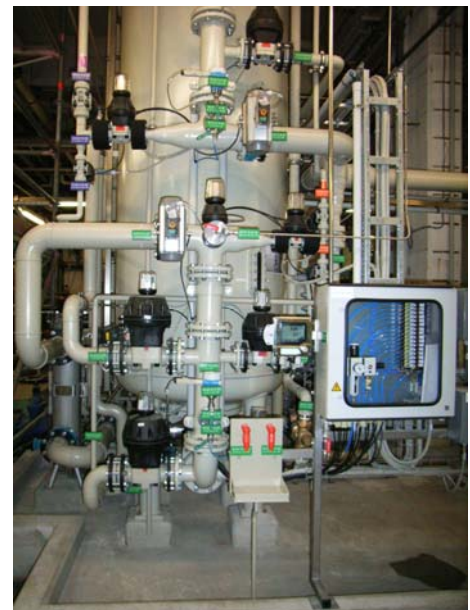
Mischbettfilter zur Feinreinigung
