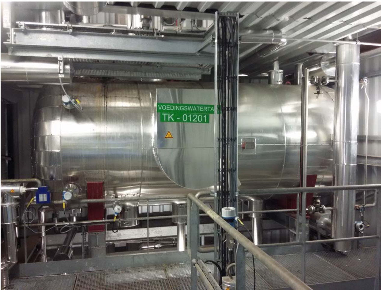
Entgasungsanlage nach kundenseitiger Installation und Isolierung
