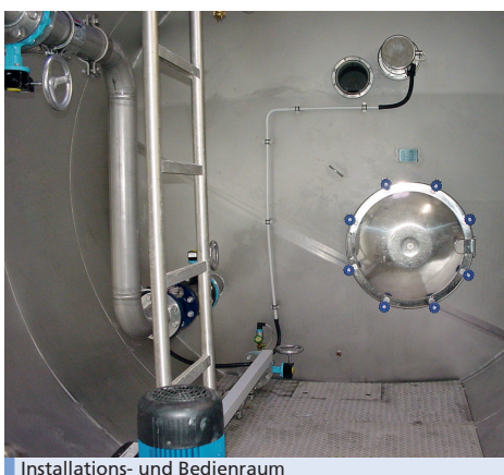
Installations- und Bedienraum
