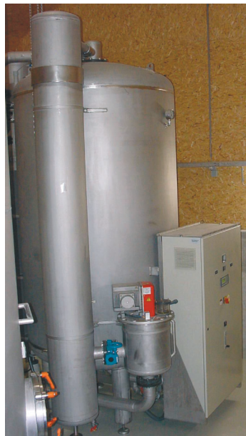
Bild 4: Trinkwasser-Kompaktanlage mit Schaltschrank und Ozonerzeugermodul
