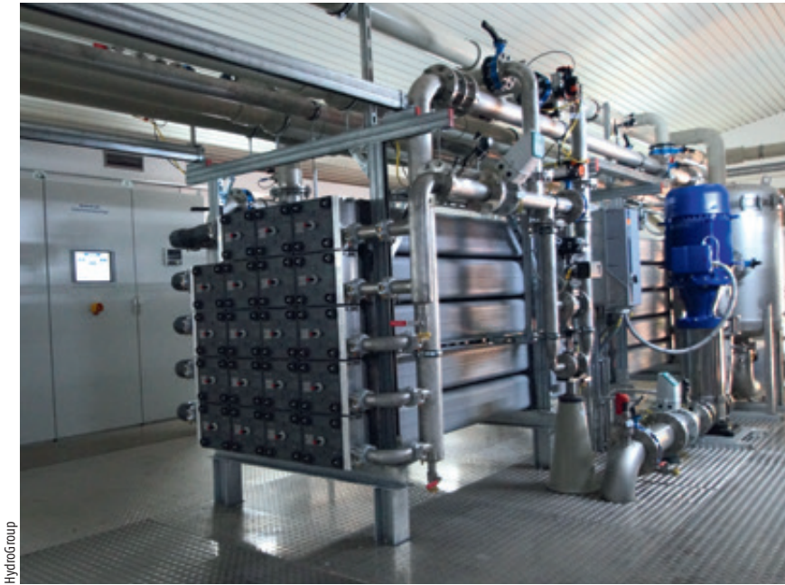
Abb. 5 – LPRO-Rack mit Schaltanlage
