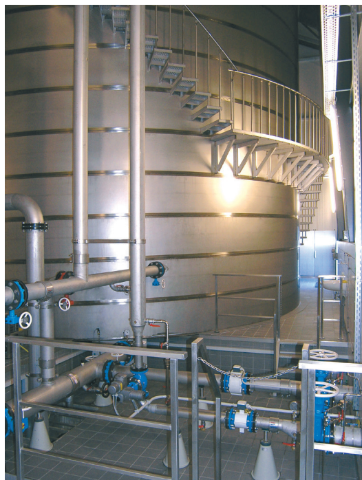
Behälteranlage mit Installation
